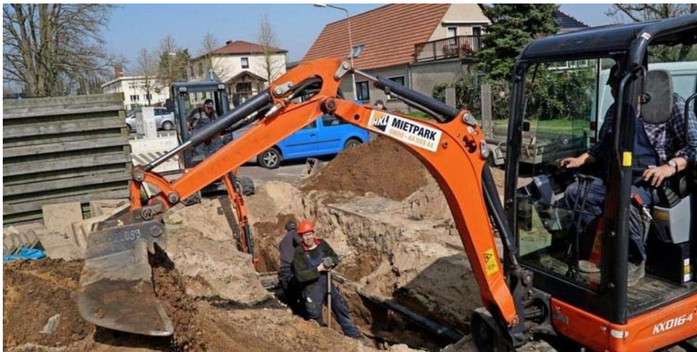
Mitarbeiter der Meyenburger Elektroanlagenbau reparierten am Dienstag im Auftrag der Stadtwerke eine Havarie an der Mittelspannungsleitung am Meyenburger Tor. Quelle: Andreas König
